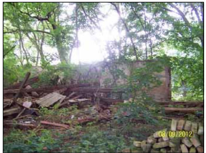
Nebengebäude südwestlich des Gutshauses (es ist nur noch eine Außen-Längswand vorhanden)
