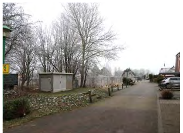
Trafostation am Feldweg südwestlich des Plangebietes, Blick von Nordwest
