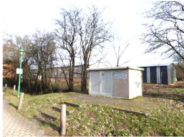
Trafostation am Feldweg südwestlich des Plangebietes, Blick von Südwest
