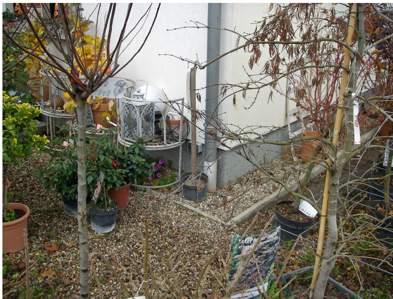
Abb. 22: Direkteinleitung der Dachflächenentwässerung in eine Rohrrigole, hier die Südostecke des Büro- und Sozialgebäudes. (Foto RIK: P1010020.JPG)
