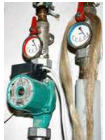
Dämmungen für Leitungen und Anschlüsse
