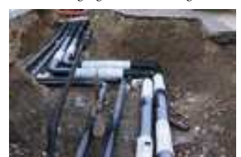
Rohre auch in der Erde gut dämmen
